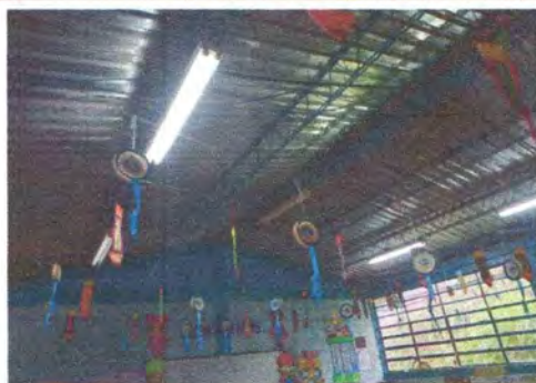
Foto 5: iluminación de aulas en mal estado
